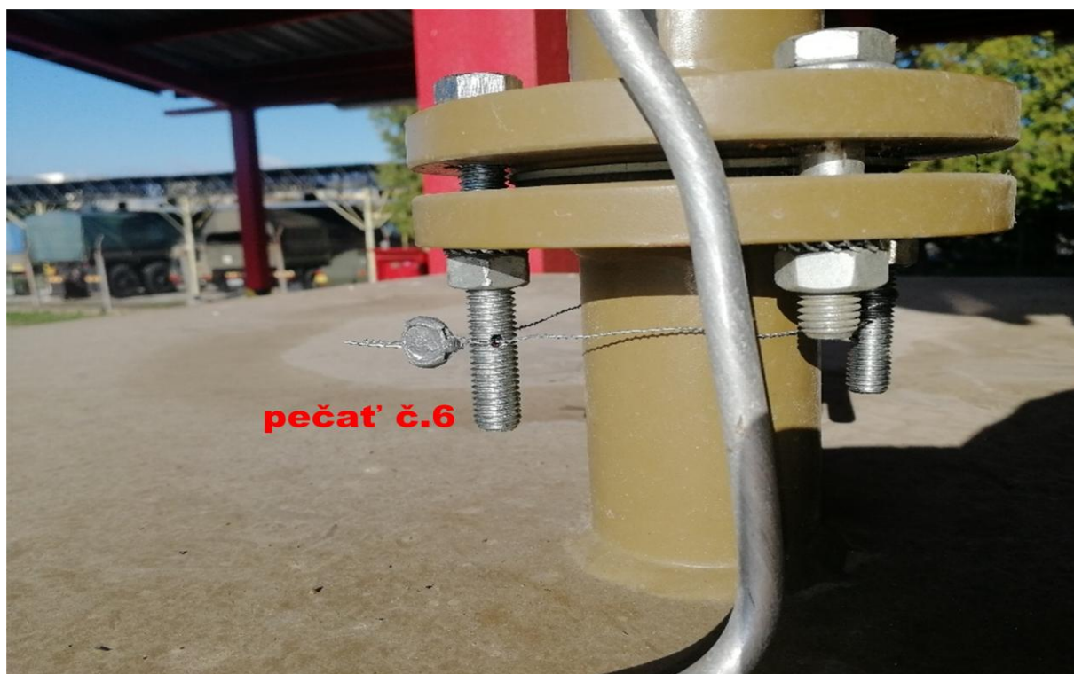
Obrázok č. 18. Detail pečate č. 6- zapečatil revízny technik na odvzdušňovacej armatúre.
