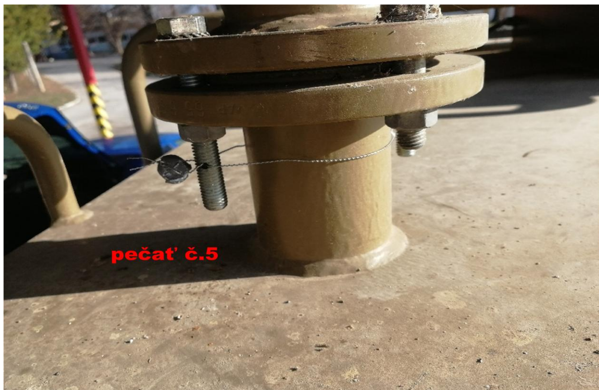
Obrázok č. 17. Detail pečate č. 5 vykonanej revíznym technikom na stáčacej/plniacej armatúre.
